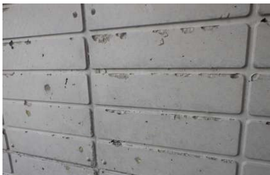
<気泡(あばた)> エア溜りによるコンクリート充填不足によるもの。
